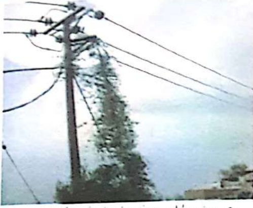
2 - الشجرة تلامس أسلاك الشبكة الكهربائية
